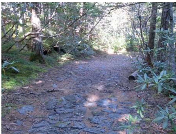
確かにここをバスが通っていたのであろう。。。石畳の舗装
