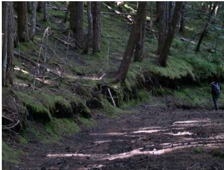
斜面が浸食され赤松が倒れそうな場所もある
